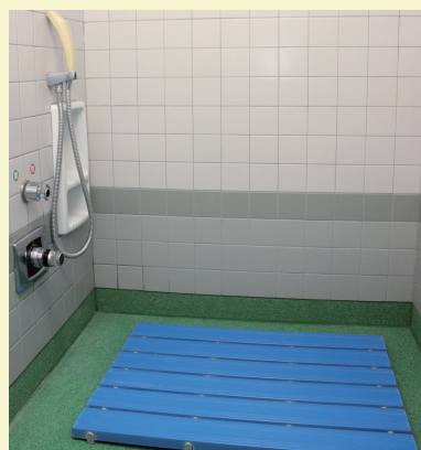
排水の位置などに配慮したすのこを設置 〔武蔵野総合体育館〕
